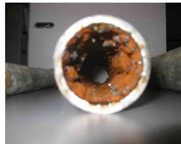
Eksempel på brugsvandsrør med aflejringer
