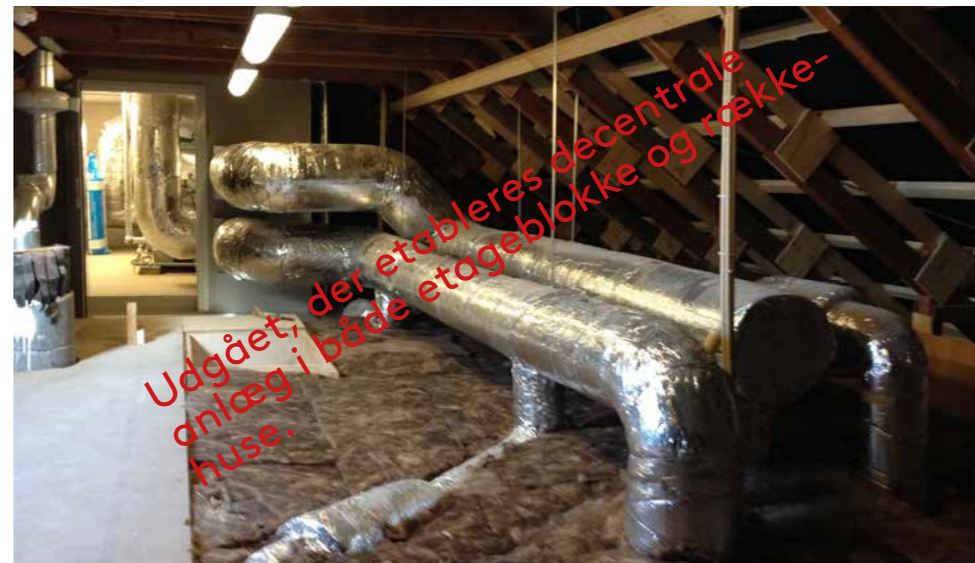
Eksempel på et centralt ventilationsanlæg i etageblokkene.
