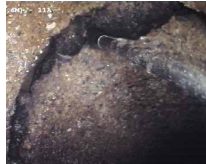
Brud på kloakrør
